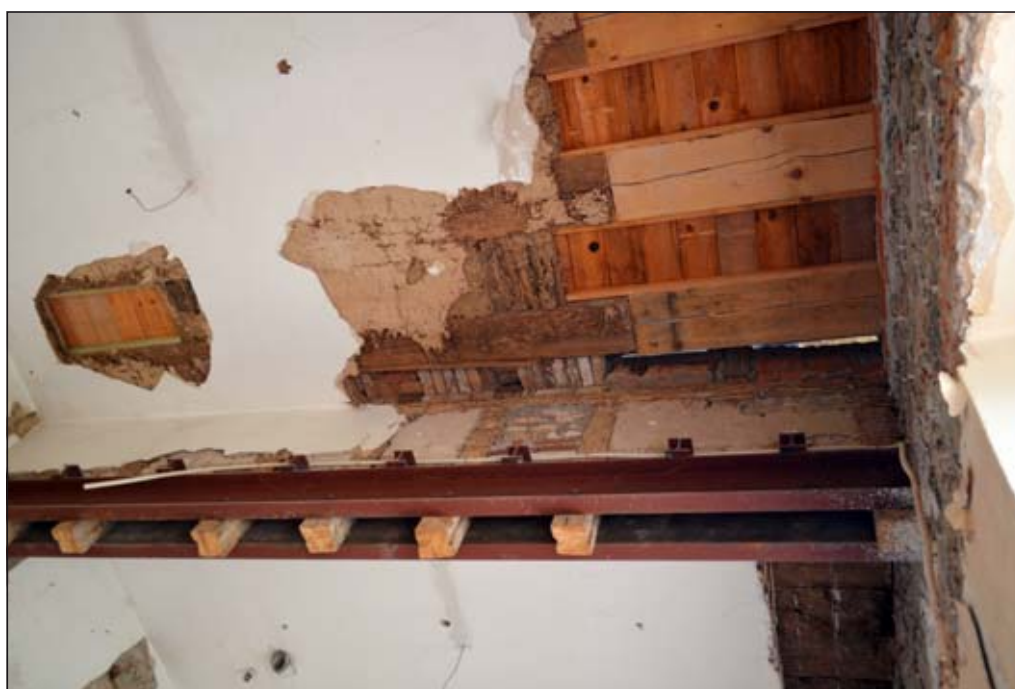
Dazu müssen Wände und Decken freigelegt werden, um dann später wieder mit entsprechenden Materialien verputzt zu werden.
